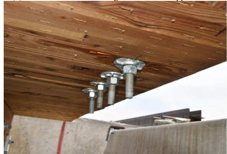
(d) Damage to Malleable Iron Washers
