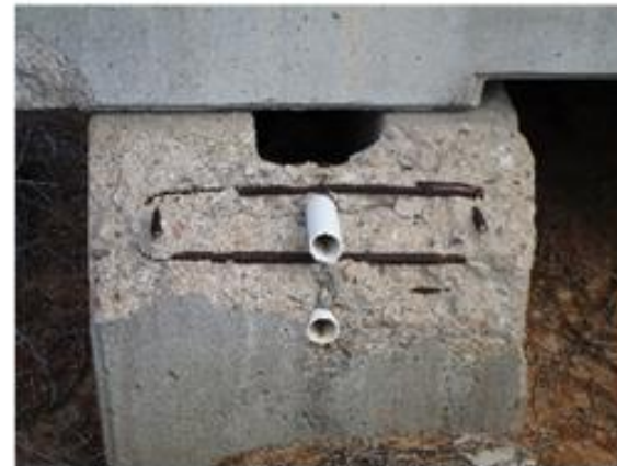
(d) Large spalled area
