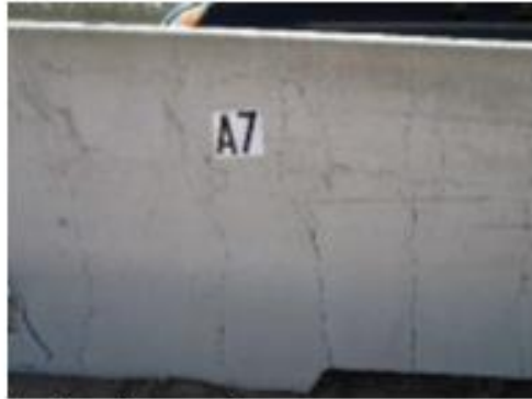
(d) Multiple cracks
