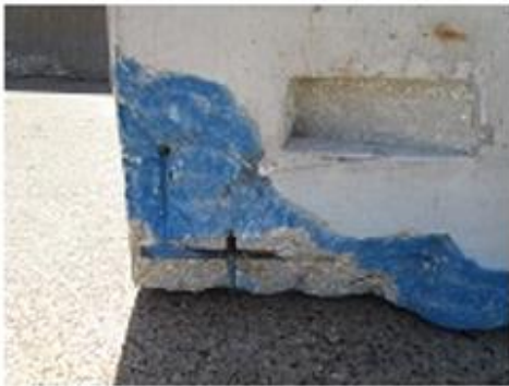
(d) Exposed reinforcing steel
